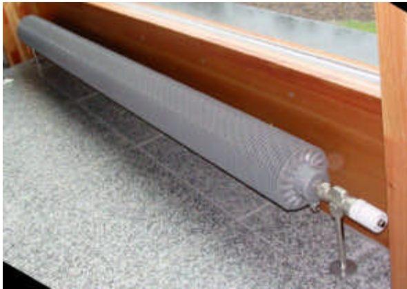
Abb. 24 Rippenrohrheizkörper in den Bürogeschossen
