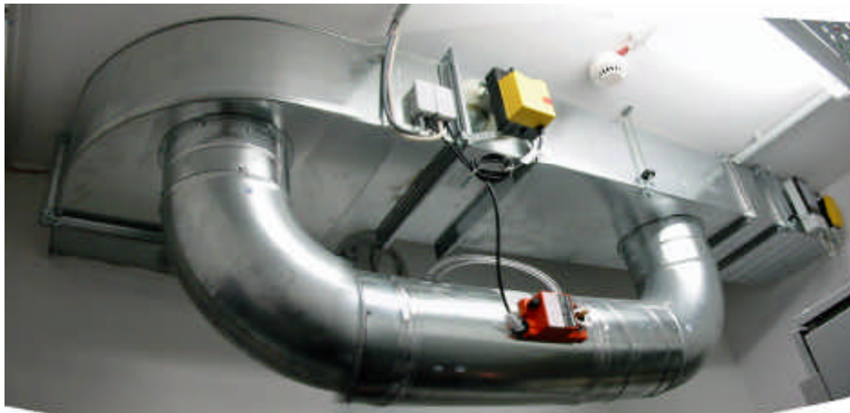
Abb. 27 Bypass (untere Leitung) für den Nachtlüftungsbetrieb
